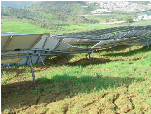
Zone endommagée par une coulée de boue
